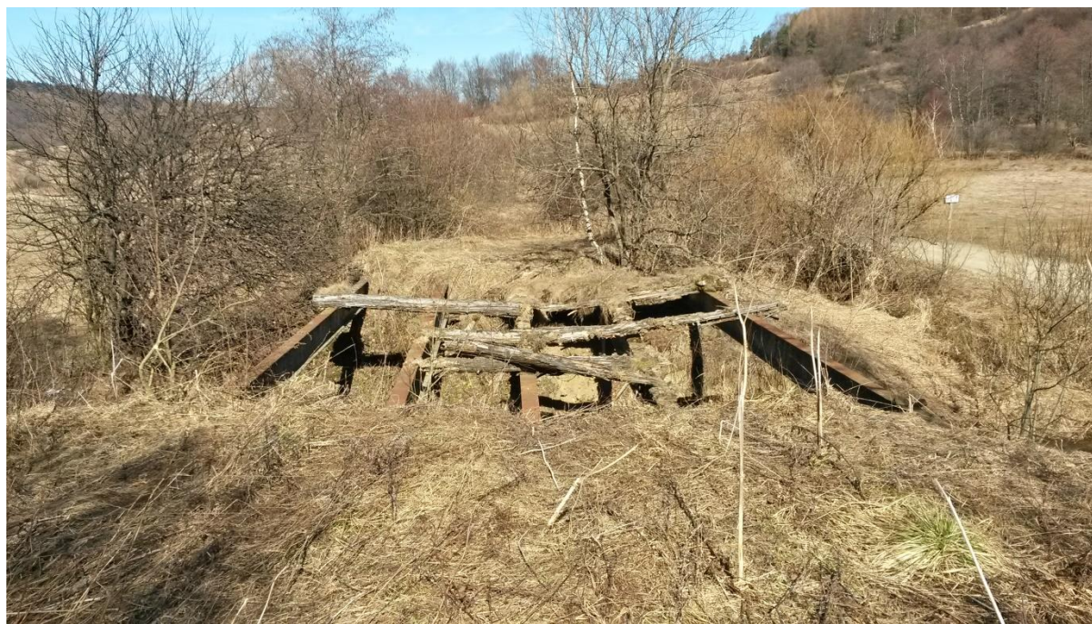
Fot. 27. Zrujnowany most na Bielczy wzdłuż dawnego traktu węgierskiego, na granicy pomiędzy Lipowcem a Czeremchą
